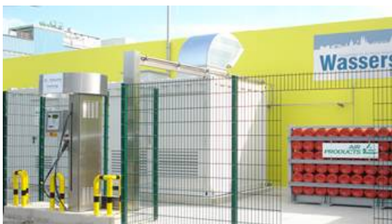
Fig. 1. Hidrogenera de AIR PRODUCTS en Hürth, cerca de Colonia.
