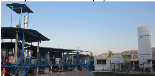
Fig. 2. Vista de la planta piloto instalada en la EDAR Murcia Este
