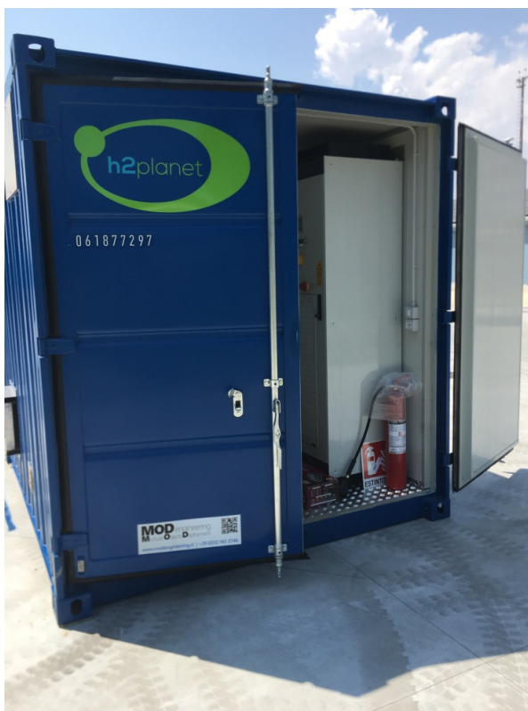
Fig.8. Imagen de uno de los contenedores que conforman la solución H2BRIX.
